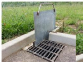
Vanne guillotine de protection des eaux profondes
